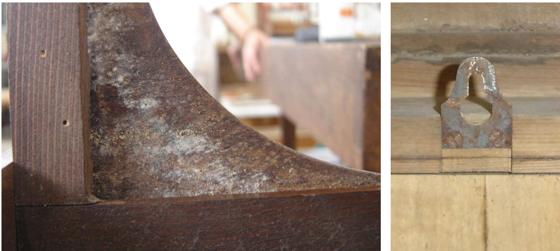
Pormenor de fungos encontrados na madeira, na parte interna da porta (esq.ª). Elemento metálico que fixa o relógio à parede oxidado (dir.ª).
