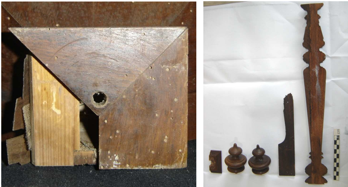
Pormenor onde é visível a falta de elementos na zona inferior (consola), orifícios resultantes do ataque de insectos e destacamento da folha. (esq.ª). Elementos soltos (dir.ª).
